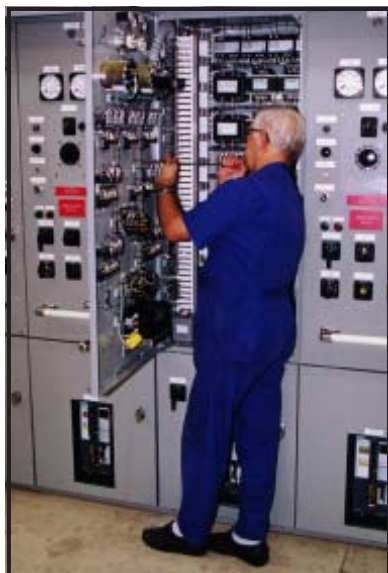
Generator Control Switchgear Wiring
