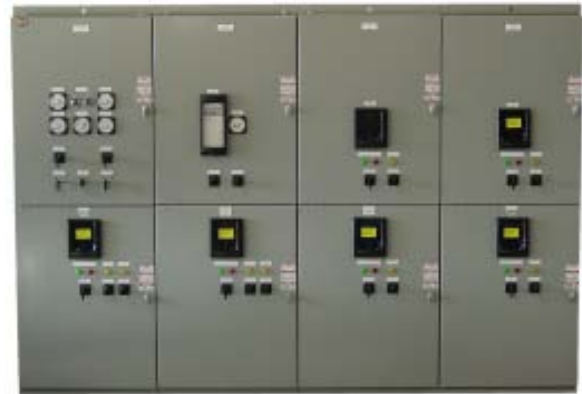
15KV Metal Clad Switchgear
